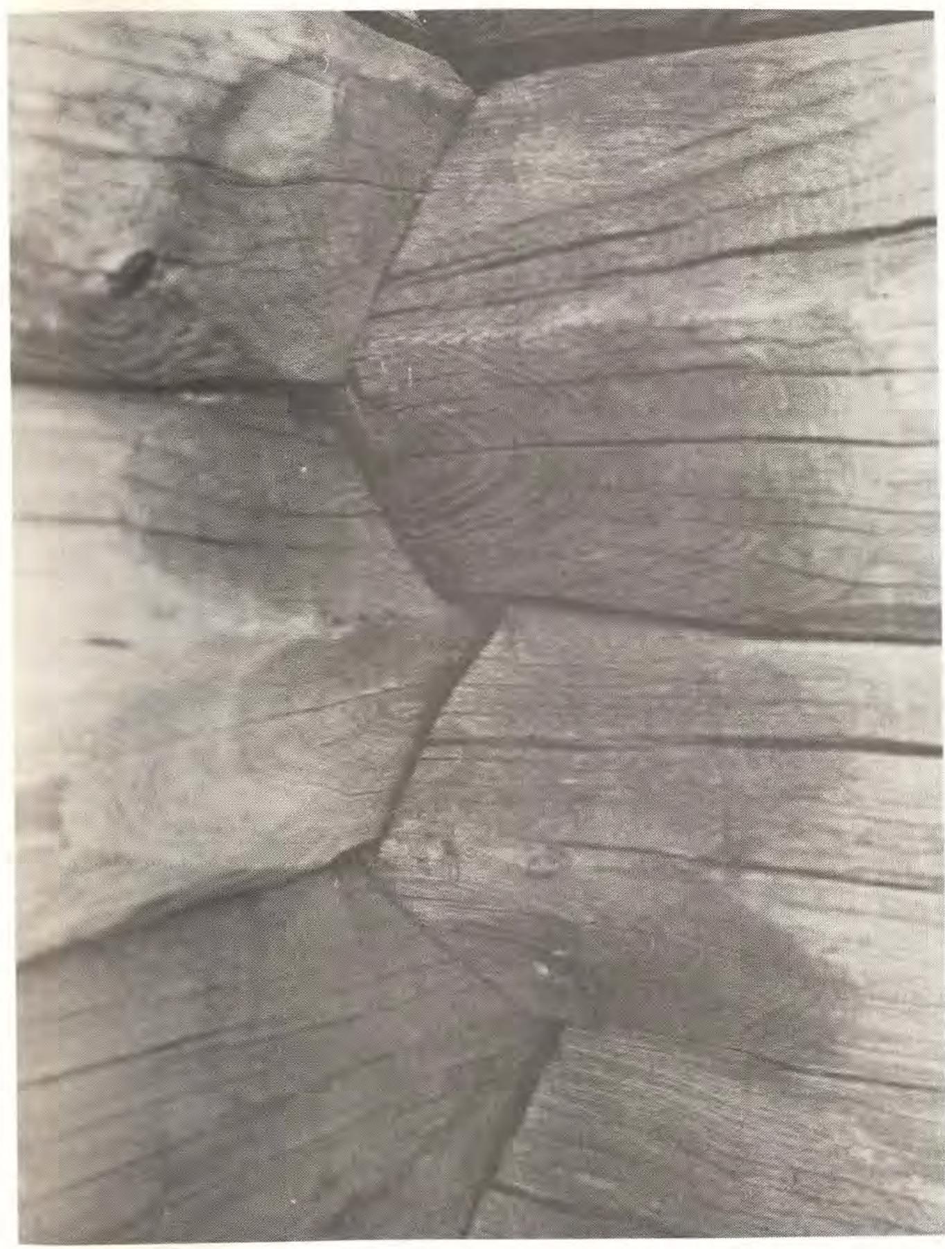
Figur 70. Härbre i Mockfjärd (troligen 1600-tal). Foto 1987. Av timringen kan man utläsa att härbret är byggt av en oerfaren timmerman. Knuten innehåller en detalj som en säker timmerman skulle ha betraktat som slarv och o-skickligt arbete. Draget går över fasningen. I en riktigt huggen knut skall en del av stockens rundning finns kvar mellan fasningen och fogen.
