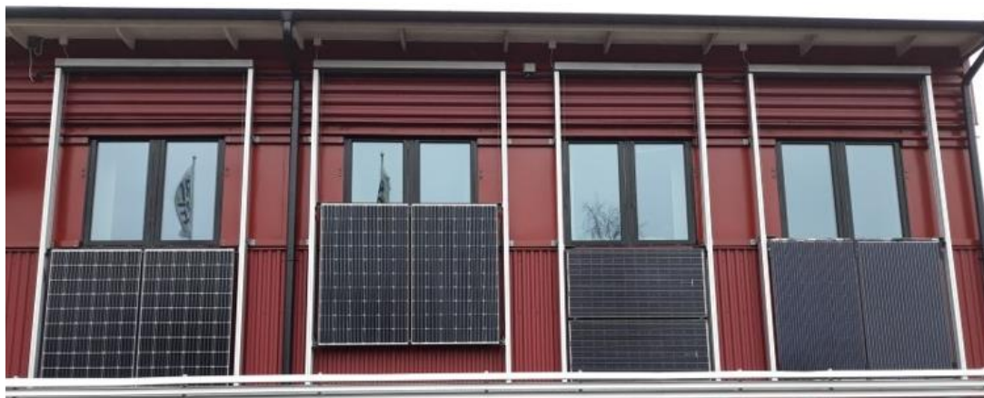
Figur 9 Vertikala moduler för solavskärmning monterade på plan 2 vid RISE kontor i Borås. Från vänster till höger: Onyxium 2*290 W p vit polymerbaksida (fönster 1 o 2 från vänster), Onyxium 2*195 W p transparent polymerbaksida (fönster 3), Transparium 2*310 W p transparent glas/glas-modul (fönster 4)
