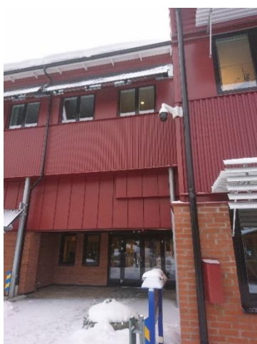
Figur 11 Snö som samlas på solavskärmningarna vållade en del bekymmer under den gångna vintern
