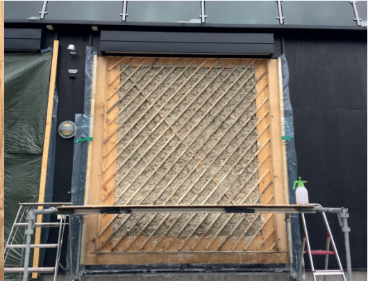
Figur 6. En bulhusvägg med hampakalk tilläggsisolering under uppbyggnad på Energi- och Byggnadsdesign laboratorium, Lunds Tekniska Högskola.
